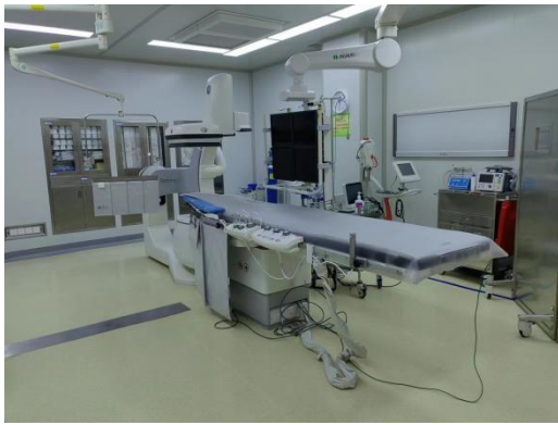
照片1 建成后机房内照片
